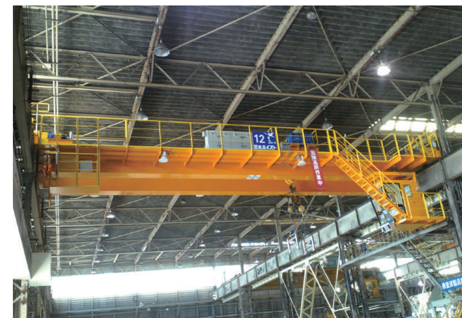
12t×17.1mクラブロリ式天井クレーン
