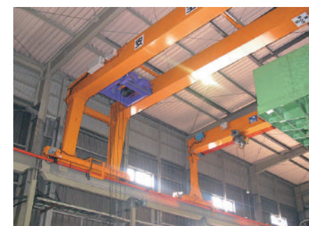
ケタカン・脚付天井クレーン
