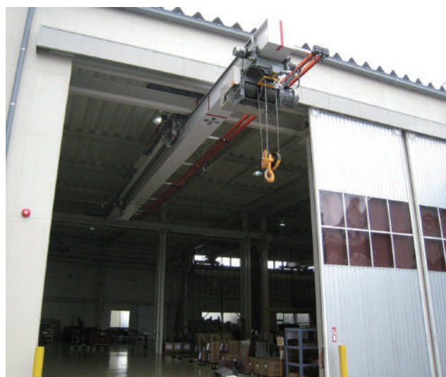
伸縮式天井クレーン
