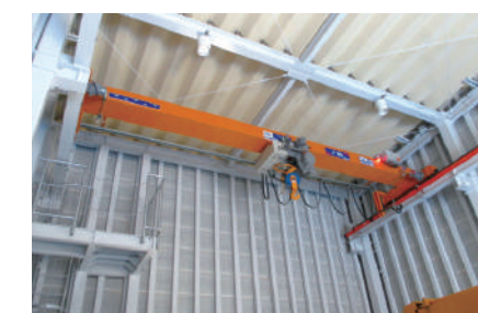
2.8t×SP6.7m天井クレーン
