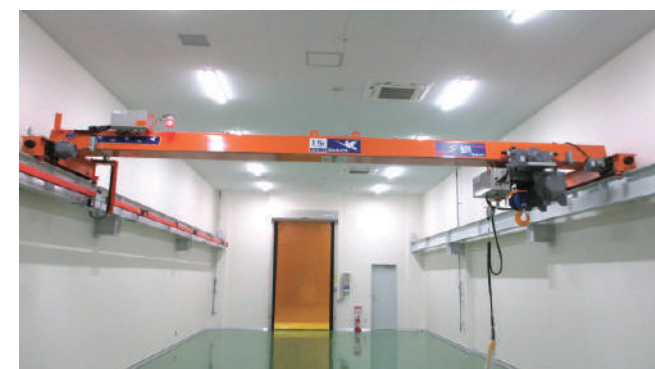
1.5t×SP6.4m天井クレーン
