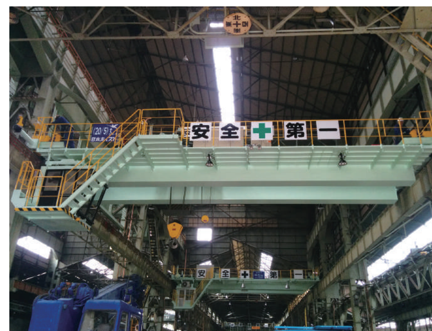
(20/5) t×SP15.028m天井クレーン
