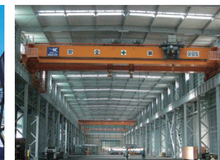
50t+50t/10t 天井クレーン
